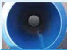
9年間使用したPE管の内面
